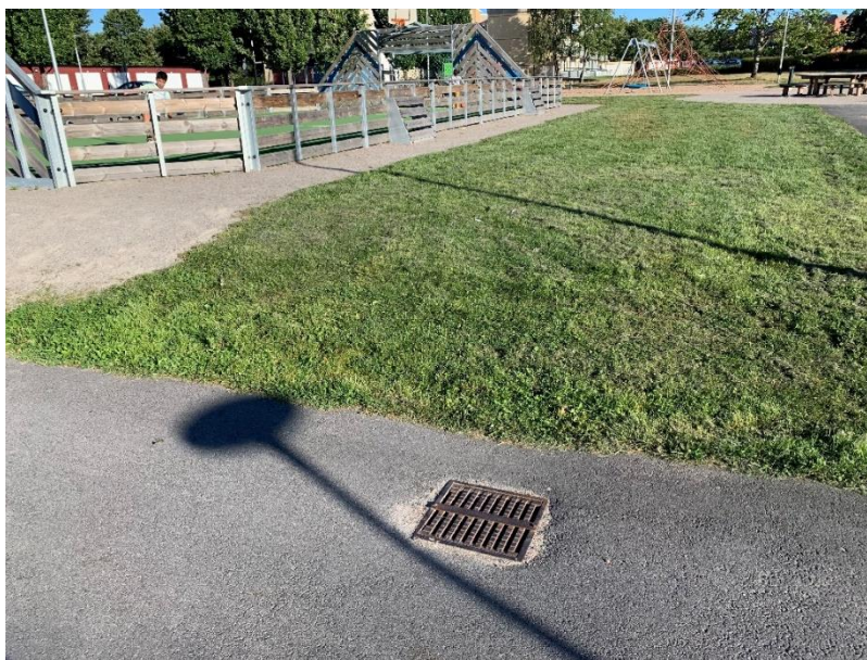
Figur 44. Provtagningsbrunn vid multisportplan.
